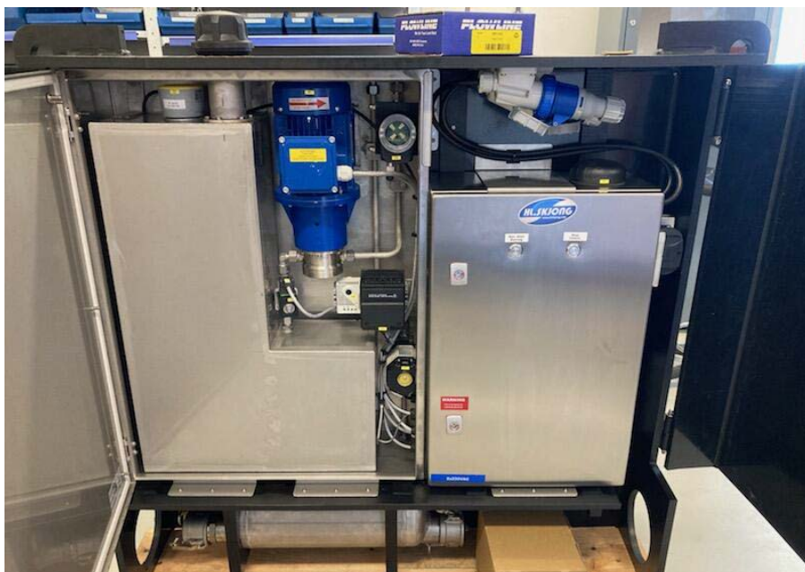
Figur 7 Ferdigstilt distribusjonssystem. Alle ventiler, pumpe-systemer og styring er innlemmet i en kompakt enhet. Foto: CCS AS/HL.Skjong AS.
